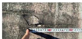
図 2 学習させた亀裂
