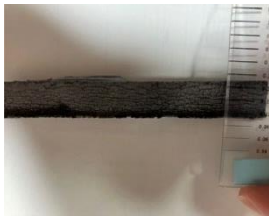
図 2a クラックゲージによる計測
