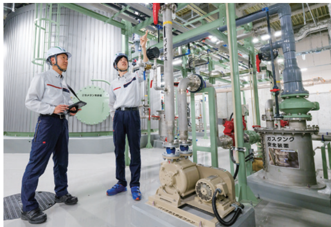
「THE LINKPILLAR 1」地下のバイオガスプラントを点検。商業施設の食品残渣（ざんさ）からつくられたエネルギーはホテルの給湯に使用される
