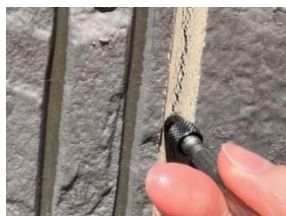
図3a 損傷深さの計測
