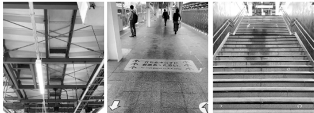
図 1 S 駅における結露発生状況
